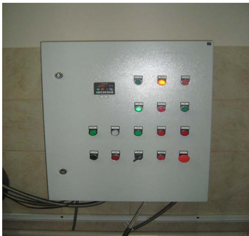
Рисунок 8 – Внешний вид шкафа электрооборудования
